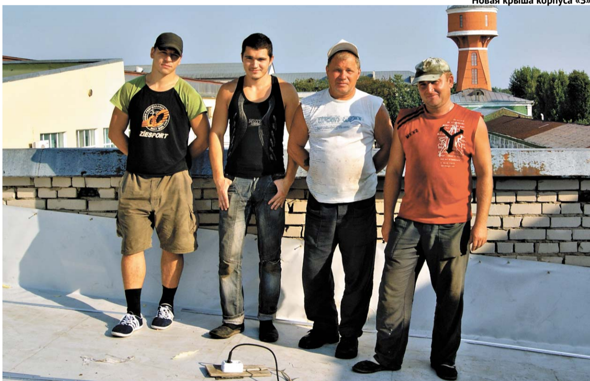
О. Карташов, А. Моисеев, С. Кузьмин, П. Мерзликин ведут работы на крыше корпуса Г-Ж.
