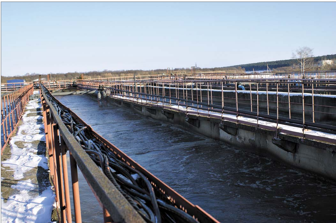
Секция аэротенка очистных сооружений биологической очистки (ОСБО).
