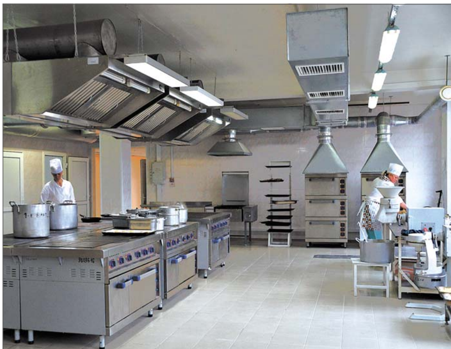
В зале для приготовления обедов – чисто, светло и новое оборудование.
